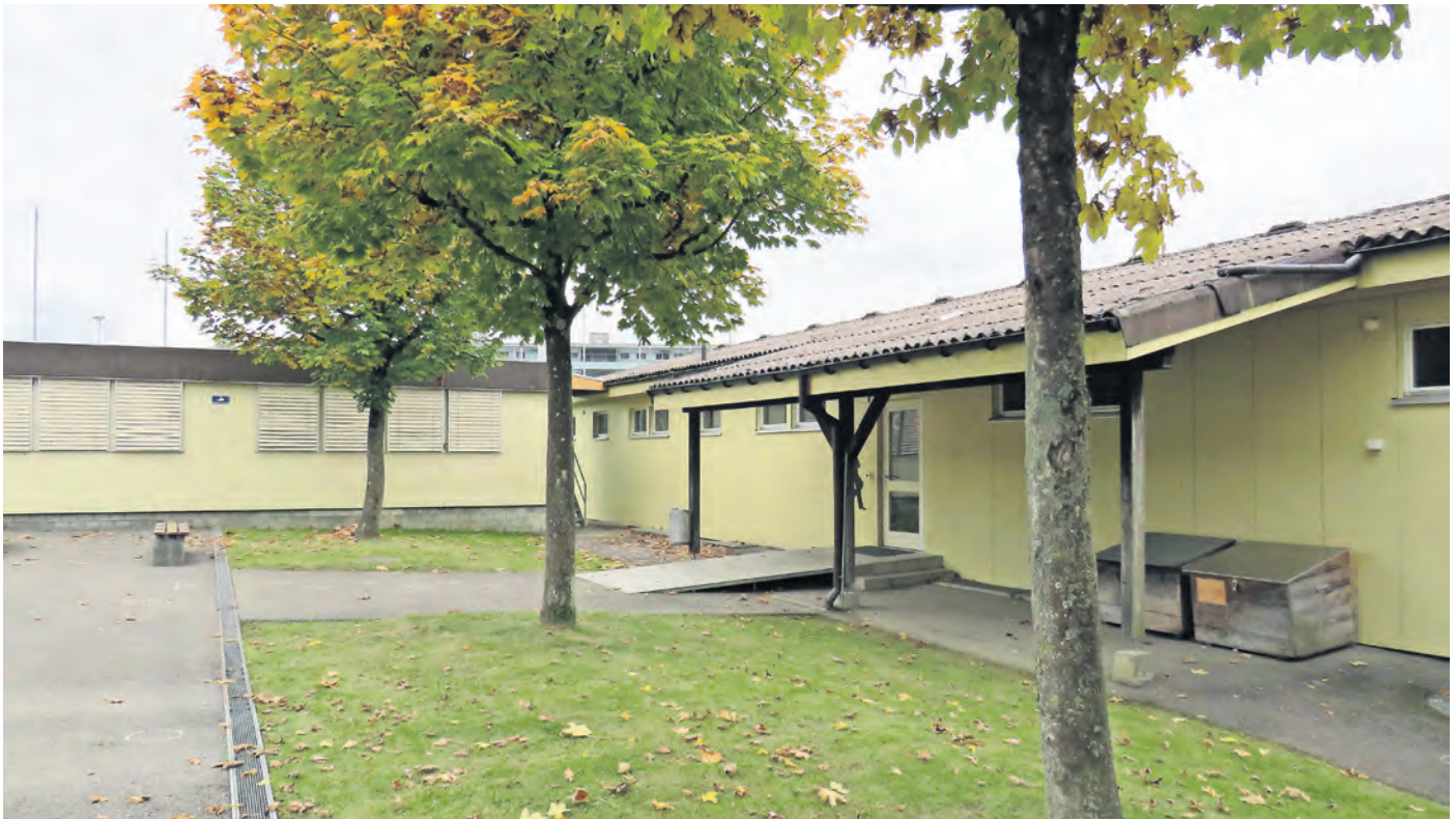
Die Schulanlage Kehlhof wurde ursprünglich als Provisorium gebaut und ist sanierungsbedürftig.
