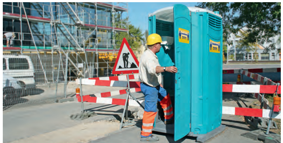
MobiToil-WC-Kabinen – ideal für Baustellen.
